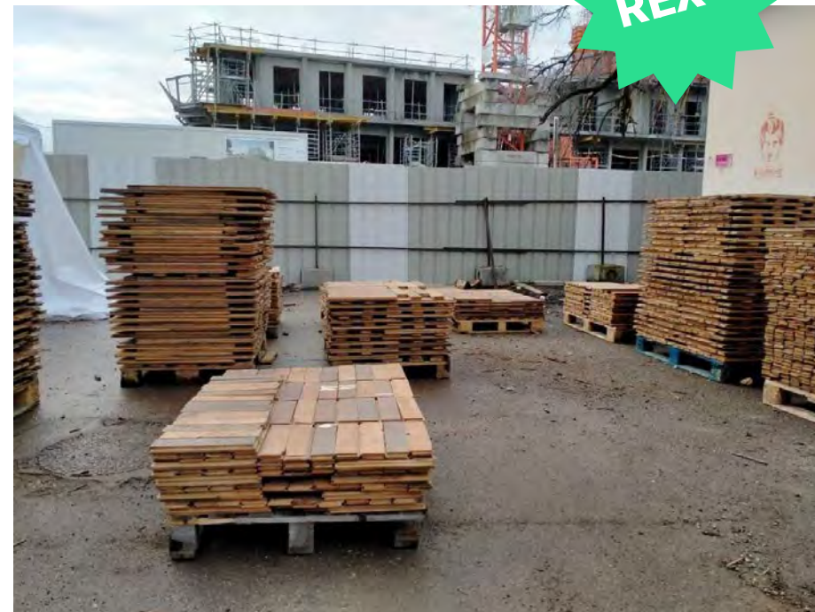
Réemploi de chantier à chantier - Est Métropole habitat (Villeurbanne) Plus-value à la dépose : 25€/m 2 VS fourniture neuf équivalente 80€/m 2 MOA : Est Métropole habitat (Villeurbanne) MOE : Neo Eco
