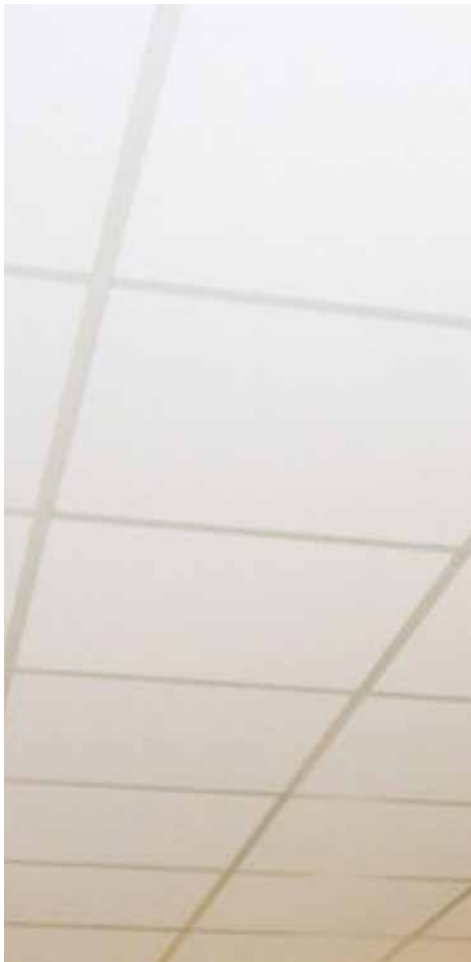
Dalles de faux-plafond
